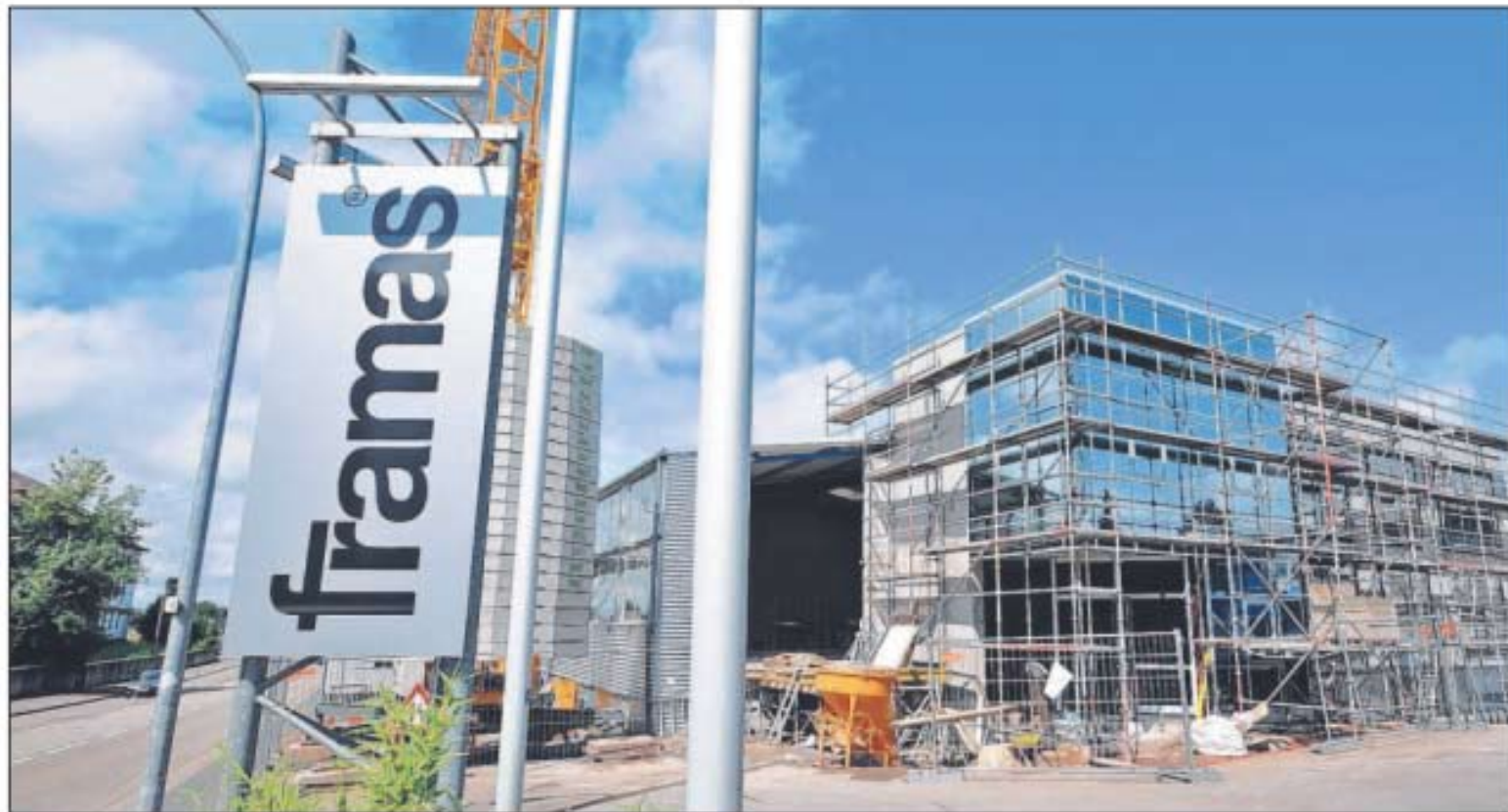
Noch wird bei Framas an der Rodalber Straße gebaut. Doch das neue Entwicklungszentrum, das Entwicklung und Formenbau beherbergen soll, wird laut Planung im September intern eingeweiht werden.
